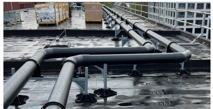
COOL-FIT leidingen op het dak van Gebouw 22.
