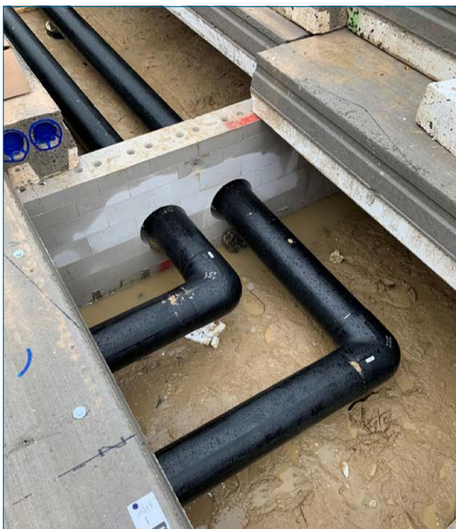
COOL-FIT 4.0 in kruipruimte
