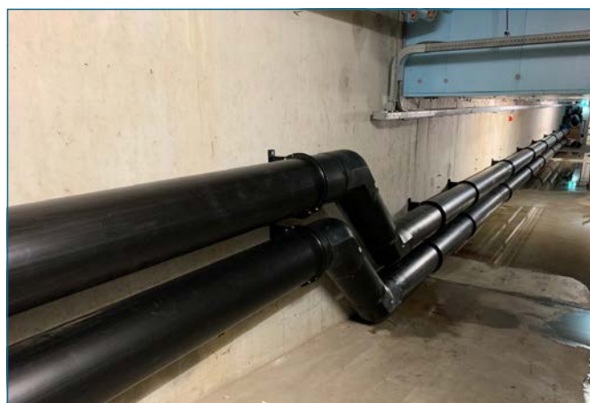
COOL-FIT 4.0 klimaatleidingen in een ziekenhuis
