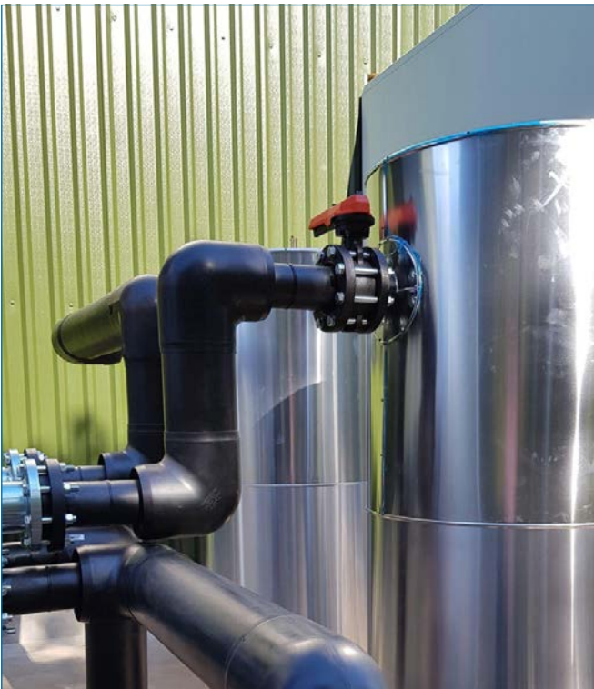
COOL-FIT 4.0 aansluiting op buffervat met vlinderklep
