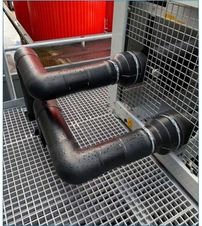
COOL-FIT 4.0 aansluiting op chiller
