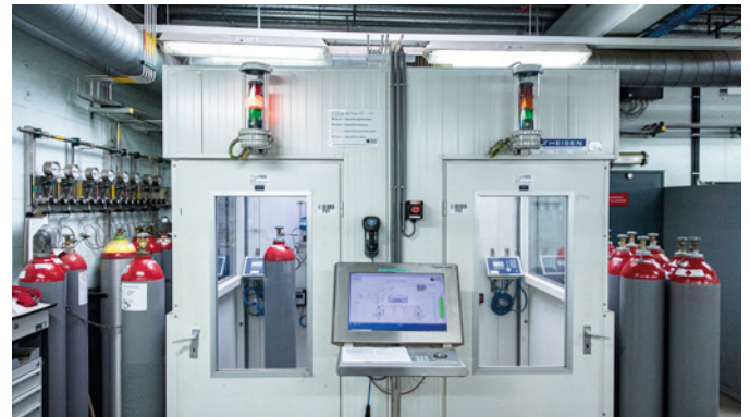
Gasreste in Speicherzylindern und Behältern müssen neutralisiert werden, bevor sie erneut befüllt werden.
