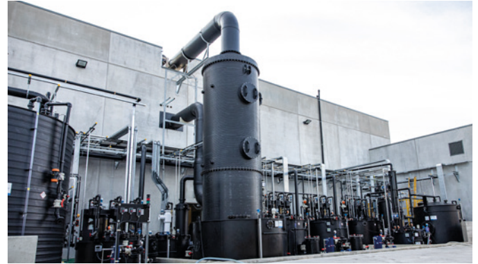
Mess- und Regeltechnik sowie manuelle und automatisierte Ventile optimieren den Betrieb der Abluftbehandlungsanlage.
