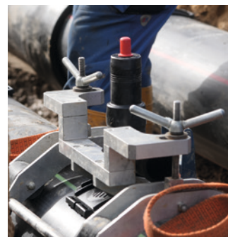
Für das Nachhaltigkeitsprojekt kommen u. a. Druckbohrventile von GF Piping Systems zum Einsatz. Sie sind vor dem Schweißen um 360° drehbar.
