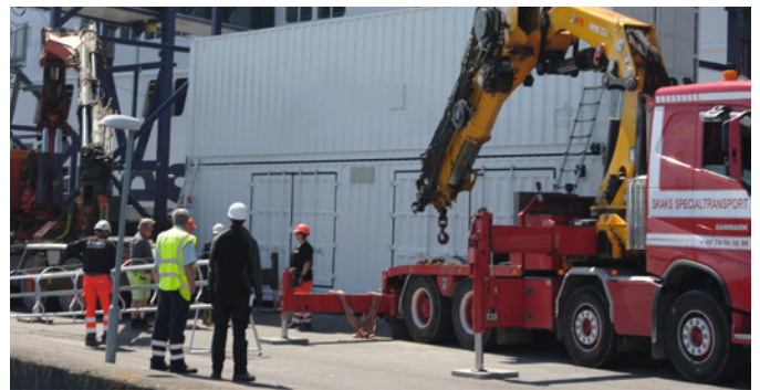
In Containern installierte MarinePaq-Onshore-Anlage im Hafen in Dänemark.
