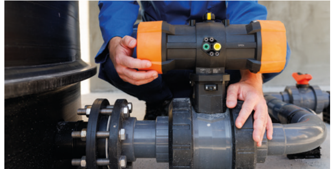
Die Kombination aus dem Kugelhahn 546 Pro Big Dimensions, dem pneumatischen Stellantrieb PPA und dem LED-Rückmeldesensor gewährleistet eine zuverlässige und ausfallsichere Chemikalienverteilung.
