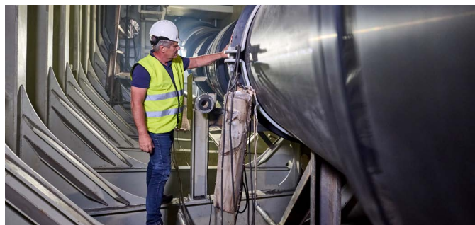
Dank Vorfertigung und schneller Verbindungstechnologien bewältigte ein Team aus 14 Installateuren die Nachrüstung in nur 2.000 Stunden.
