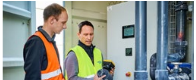
Für Parameter wie z.B. den pH-Wert erfordert der Karbonisierungsprozess dauerhafte Automatisierungslösungen.
