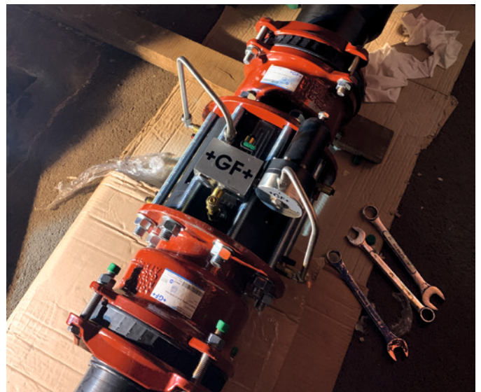
Mit NeoFlow DN150 und MULTI/JOINT 3000 Plus integriertes Rohrleitungssystem in Tangerang, Indonesia.
