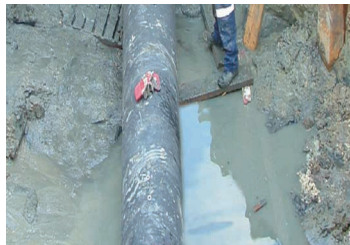
Rückständiges Wasser muss abgepumpt werden
