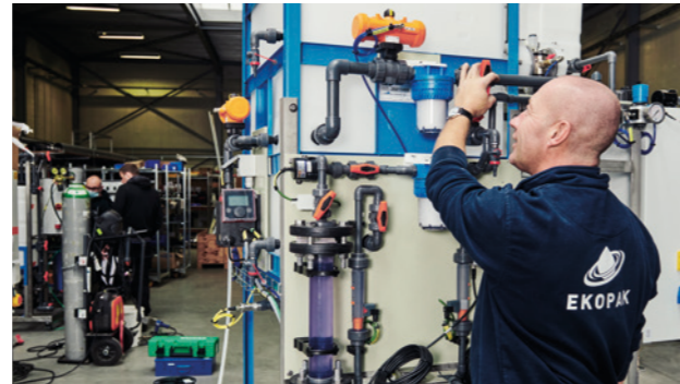
Ein Skid für die Wasseraufbereitung wird bei Ekopak in Belgien vorbereitet.
