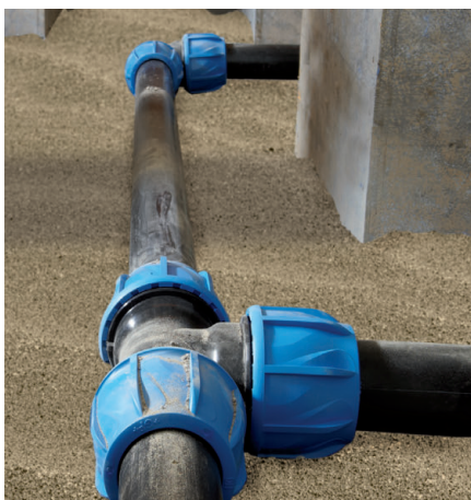
Conduites de distribution d'eau
