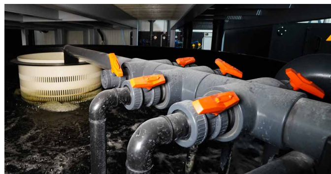
Valores da água sempre sob controle: skimmer industrial e desnitrificação.
