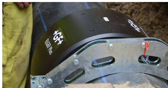
Instalação sem problemas de acopladores ELGEF Plus de d500 mm com reforço ativo
