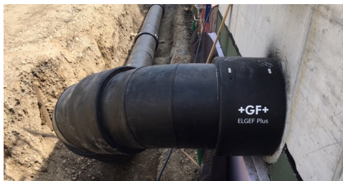
Curva apertada da tubulação de ar puro d710 mm diretamente no prédio.
