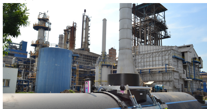
Integração rápida no local de uma sela ELGEF Plus de d1000 mm com uma saída de d500 mm.
