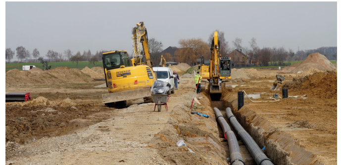
Na área de desenvolvimento “Neuer Soester Norden”, estão sendo instalados tubos que posteriormente transportarão o calor do solo para as 600 unidades residenciais.
