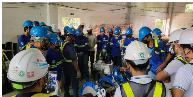
Treinamento no local para uma instalação segura, rápida e confiável do circuito de refrigeração de missão crítica.
