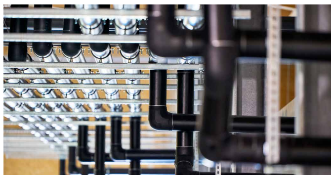
Os 600 metros de tubulação na instalação de refrigeração da Hungerbühler Fruit Farming incluem um marco importante: o milionésimo metro de tubulação COOL-FIT.
