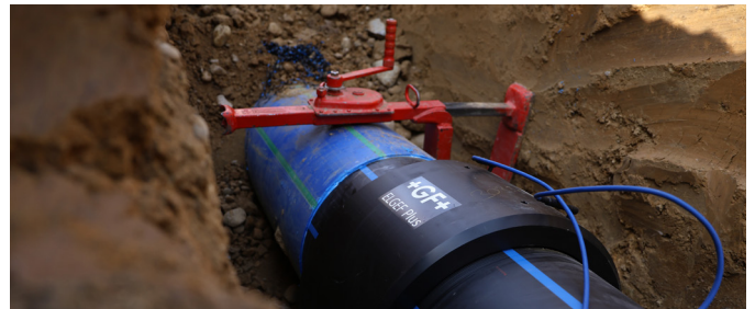
Fácil instalação do acoplador ELGEF Plus de grande diâmetro em uma vala estreita.
