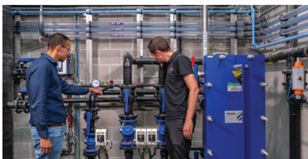
Joeri Tomas Fahim (GF Piping Systems) und Karsten Pauwels (De Halve Maan) in der Wasseraufbereitungsanlage.
