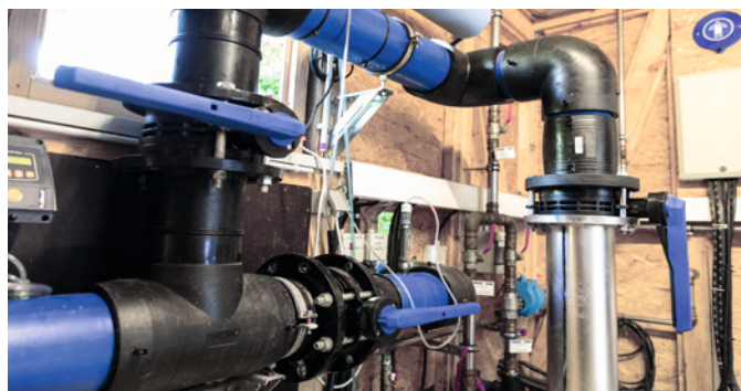
Nova Válvula Borboleta 565 no sistema de filtragem
