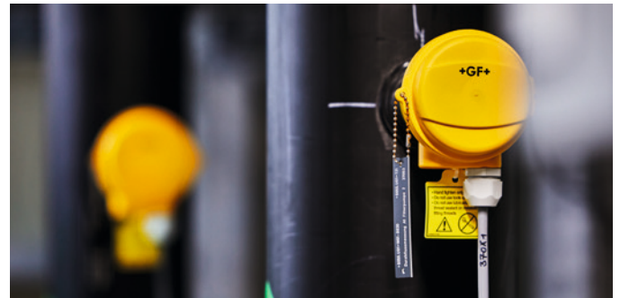
Magnetisch-induktive Durchflussmesser überwachen den zuverlässigen Betrieb.
