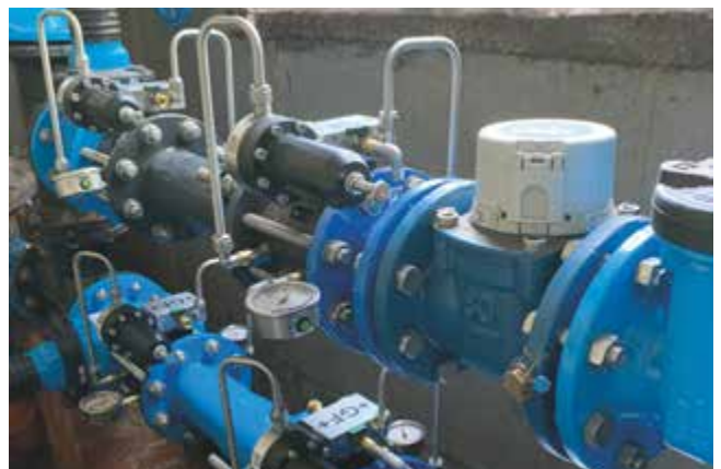
Der Betreiber entschied sich für die Installation von zwei in Reihe geschalteten NeoFlow Druckregelventilen. Zusätzlich stellt eine Reserveleitung den kontinuierlichen Betrieb sicher. Foto: Thierberger (GWK)
