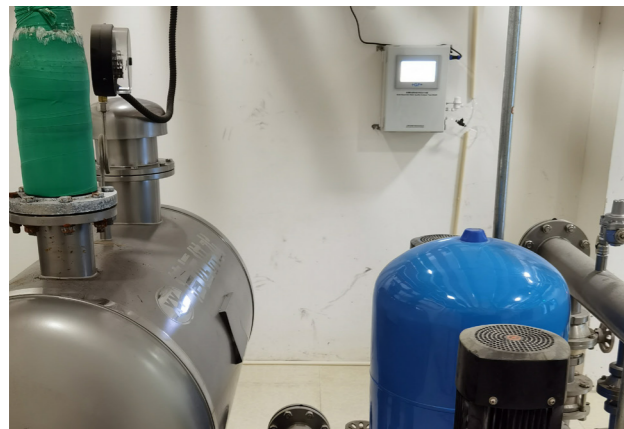
8 轻松实现饮用水水质监控 二次供水
